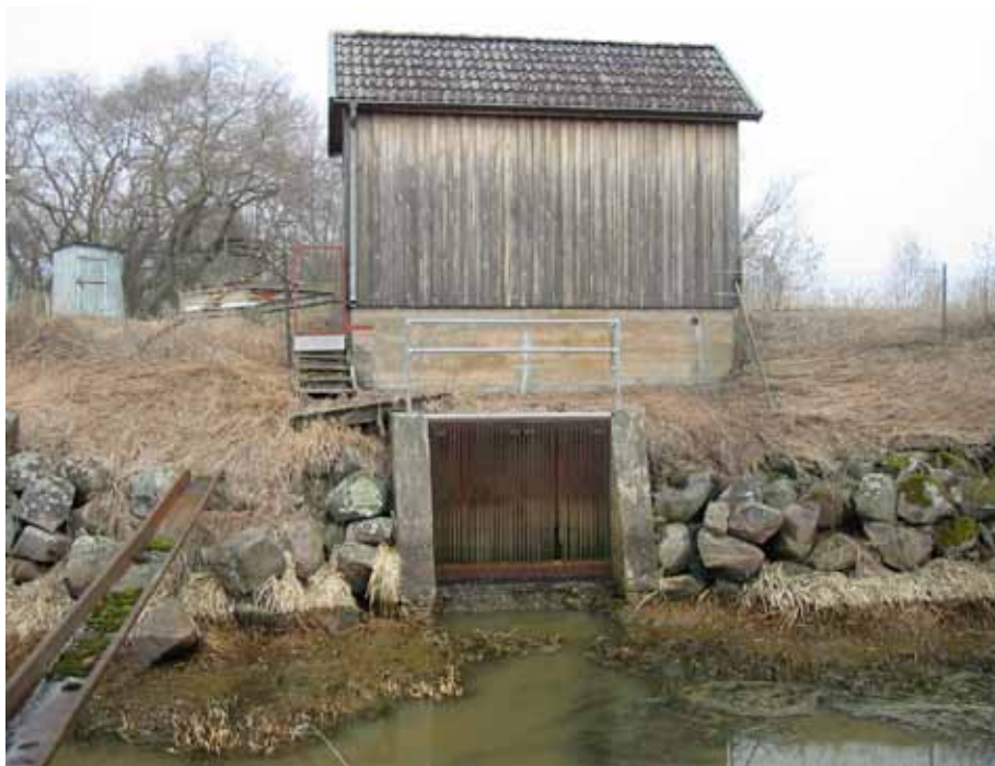
Figur 2.3.1 Intag till invallningspumpstation vid Roxen. Foto: Per Lindmark.
