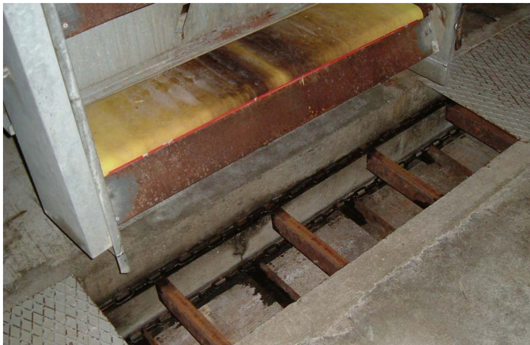
Tvärkulvert med gödselskrapor.
