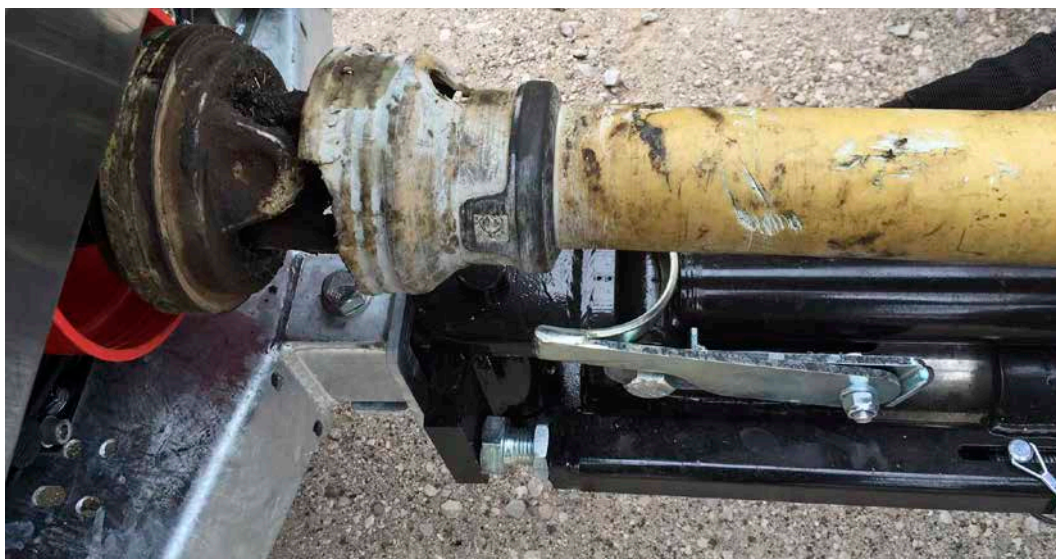
Bild 3. På bilden saknas en del av skyddet och den övre delen är skadad. Här ska den första åtgärden vara att se till att ett helt och fungerande skydd monteras.
