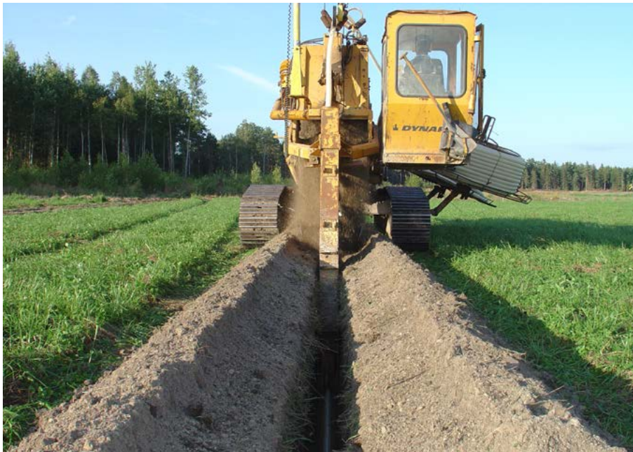
Dränering förbättrar förhållandena i marken och skapar förutsättning för en bra rotutveckling i grödan. Foto: Åsa Rölin.
