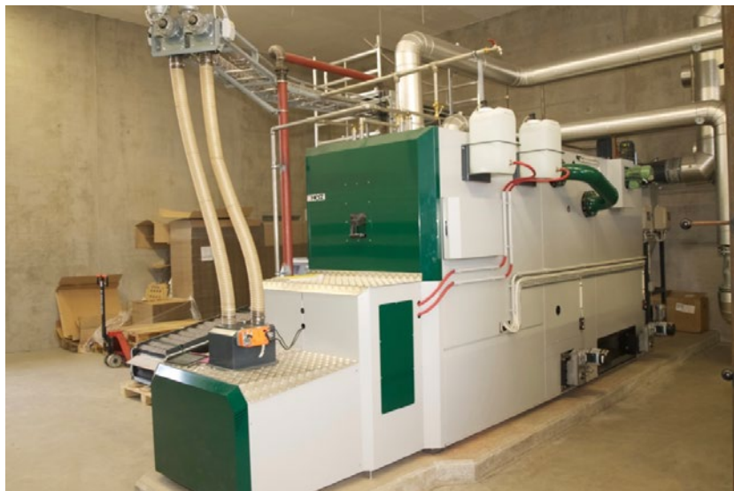
En modern pelletspanna med integrerad datorstyrning och inbyggda rökgascykloner, med en verkningsgrad på över 92 procent.
