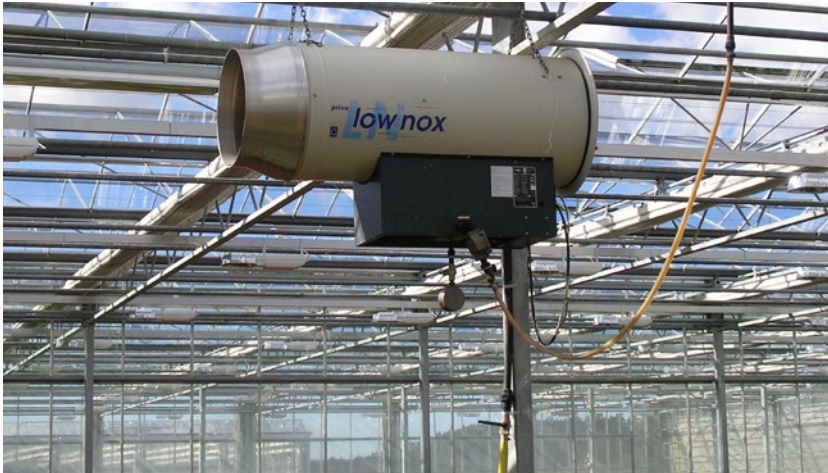
Gasbrännare för koldioxidgödning och värmeproduktion som är monterad direkt i växthuset. Beroende på storlek på växthuset används 1 eller flera brännare.
