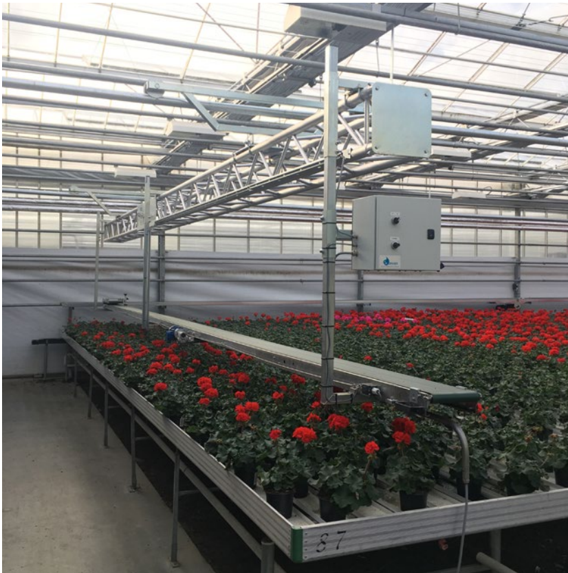
En motoriserad rullbanetravers underlättar packning och förflyttning av lådor i växthuset.
