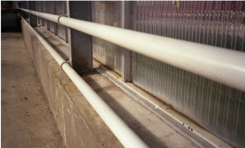
Helgjuten grundmur där stolparna är nergjutna i grundmuren. Notera att murens ovansida sluttar för att kondensvatten ska rinna av.
