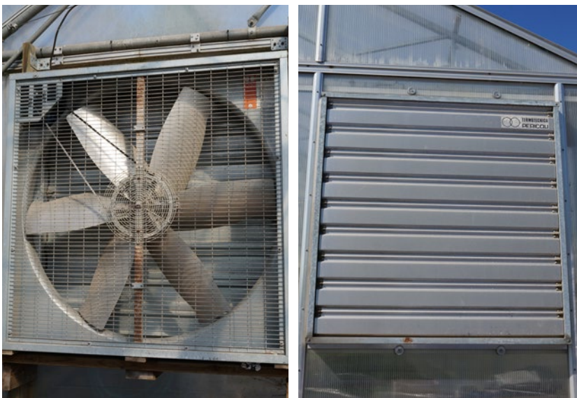
Ett reservsystem för ventilation som består av en fläkt på insidan och ett jalusi på utsidan. Foto: Elisabeth Ögren.
