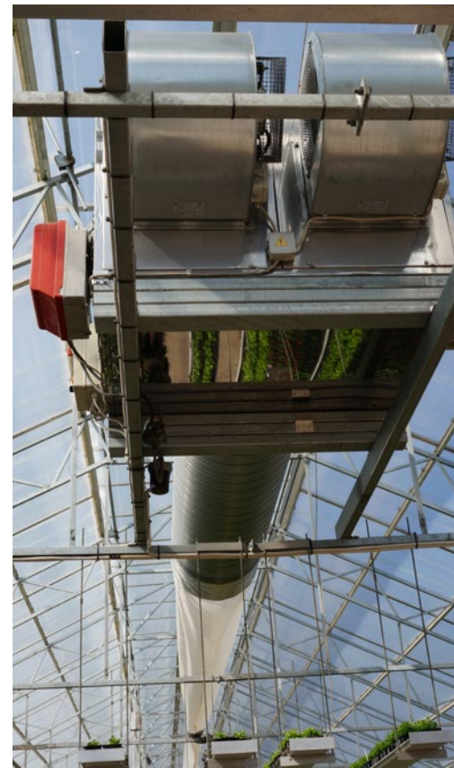
Fläkt och plastfolieslangar i taket för att sprida värme i en odling med krukor direkt på golvet. Foto: Elisabeth Ögren.
