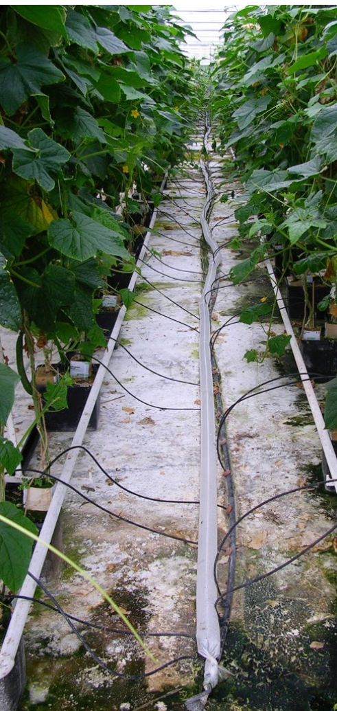
Perforerad plastfolieslang för fördelning av koldioxidrik rökgas från en gaspanna.
