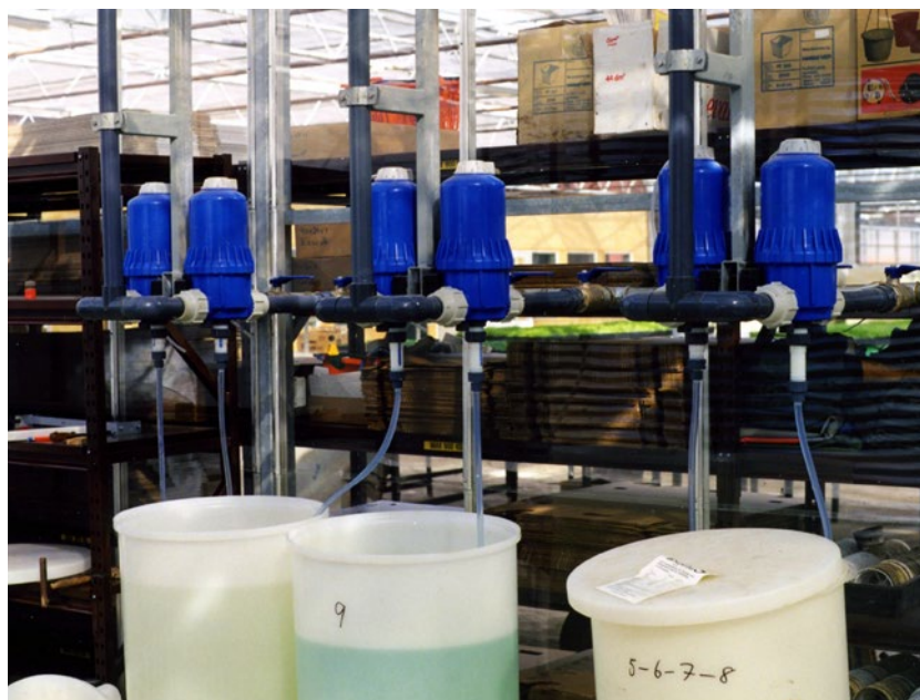
Installation av Dosatron proportionalitetsblandare. Med hjälp av ventiler väljer användaren vilket av de 3 paren som ska användas. I varje par är blandarna monterade parallellt med varandra och suger upp olika gödselmedel.
