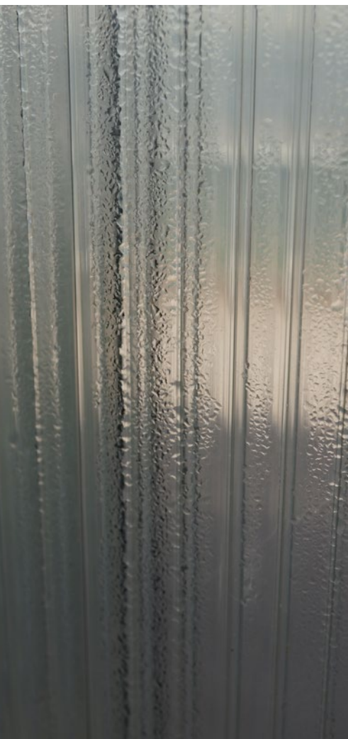
En alltför hög luftfuktighet kan leda till att vatten kondenserar på växterna och på växthusets väggar, tak och golv. Foto: Elisabeth Ögren.
