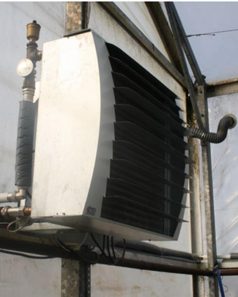
En aerotemper (fläktkonvektor) sprider värme från ett vattenburet värmesystem ut i luften. Foto: Elisabeth Ögren.
