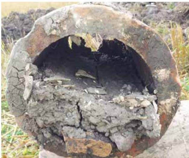
Om rören är krossade eller fyllda med jord är det dags att förnya. Foto Zivko Rasic.
