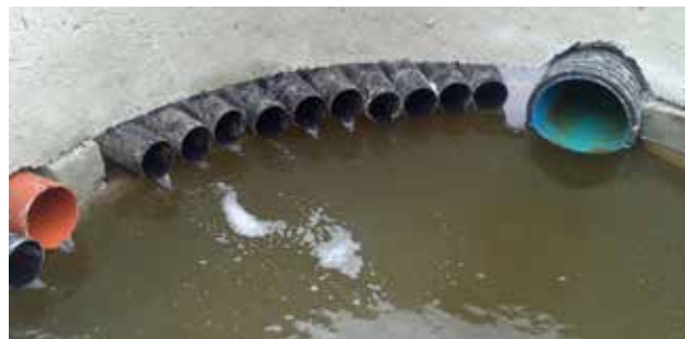
En brunn med stjärnkopplingssystem kan ha upp till tjugofem ledningar till en och samma brunn. Foto Bo Åkesson.
