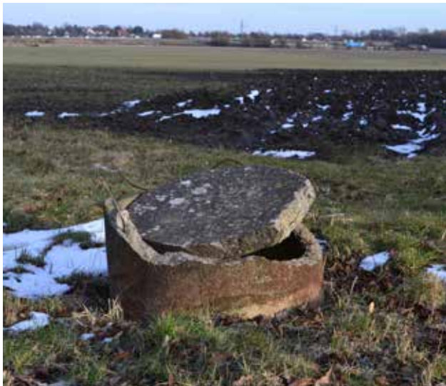
Håll koll på brunnslocket. Oavsett val av material är det viktigt att brunnslocket är helt och ligger stadigt. Både för att förhindra olyckor och att skräp eller jord kommer in i systemet och kan orsaka stopp. Foto Alva Agger.
