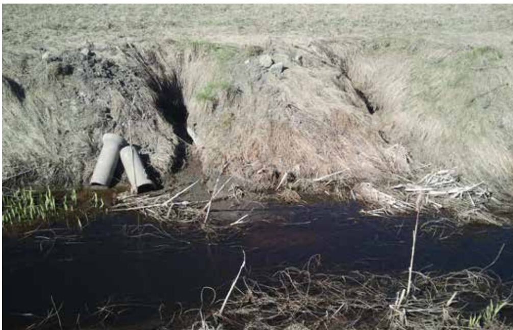
Erosionsskador i slänt och kring dräneringsutlopp. Foto: Jennie Wallentin.
