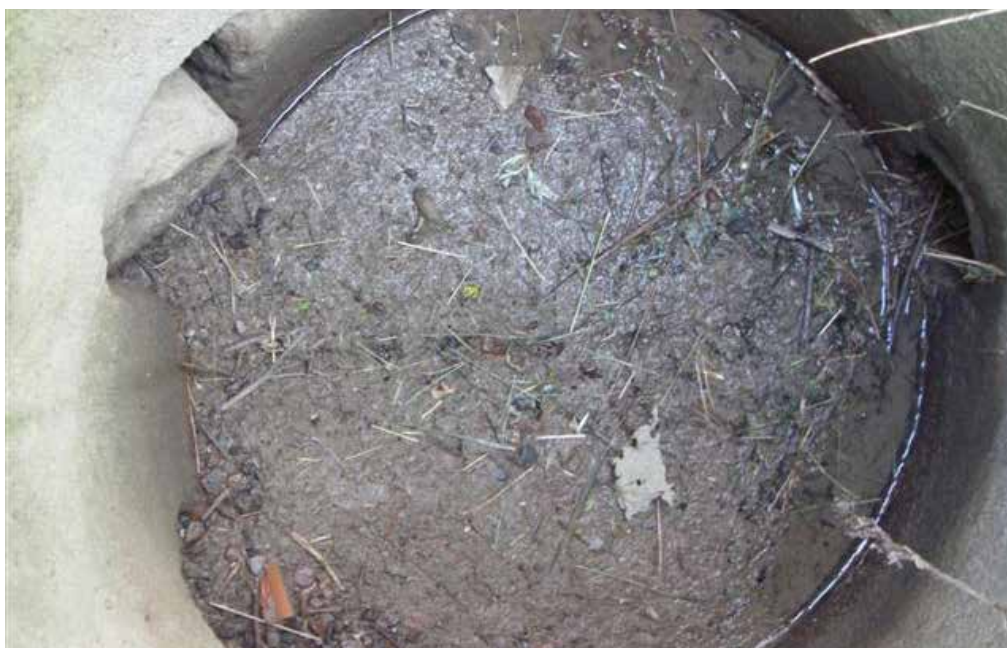
Igenslammad brunn som behöver rensas genom att gräva ur sediment i botten alternativt slamsugas. Foto: Anuschka Heeb.
