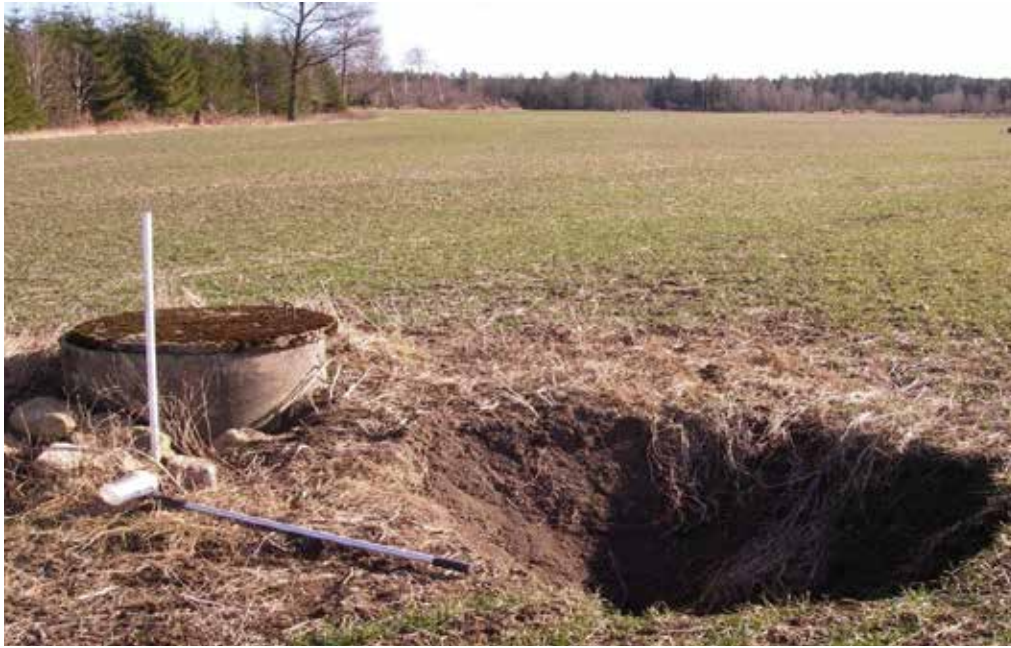
Slukhål som uppstått efter att marken kring en trasig ledning eroderat bort. Foto: Anuschka Heeb.
