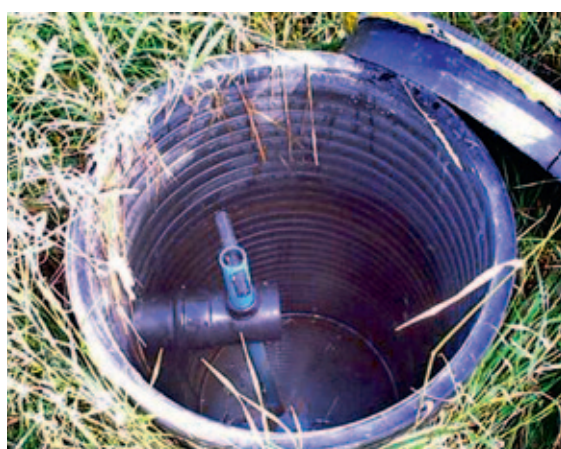
Regleringsbrunnar som styr vattennivån i åkern minskar kväveläckaget. Foto: Ingrid Wesström.
